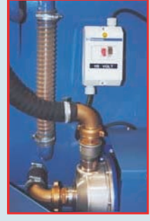
Pompa, şalter ve seviye göstergesi
